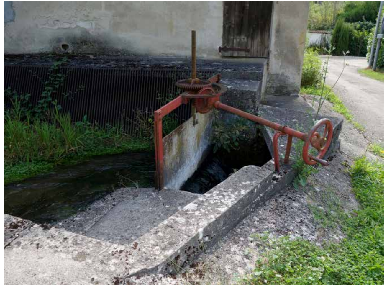
Porte régulant l'entrée d'eau dans le moulin et le canal de restitution
